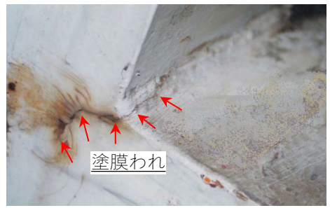
塗膜われ(疲労亀裂)
