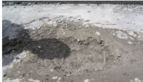
床版上面の土砂化
