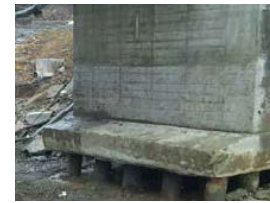
杭基礎の露出
