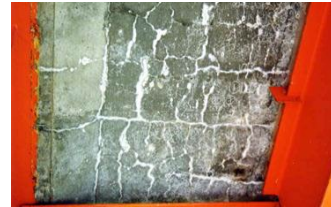
内部の鉄筋腐食が疑われる例
