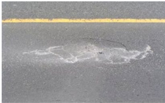
舗装のひびわれから白色析出物
