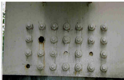
ボルトの脱落
