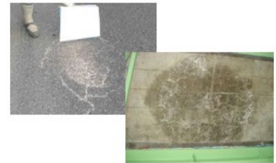
床版上面の土砂化が疑われる事例
