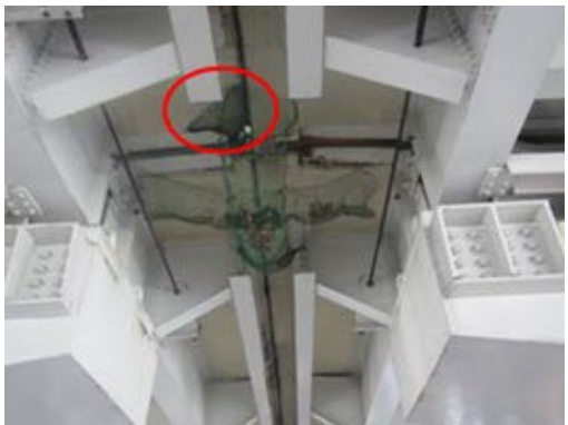
落下対策箇所の剥離
