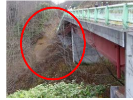
斜面上基礎の洗掘
