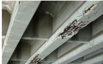
鉄筋腐食による剥離
