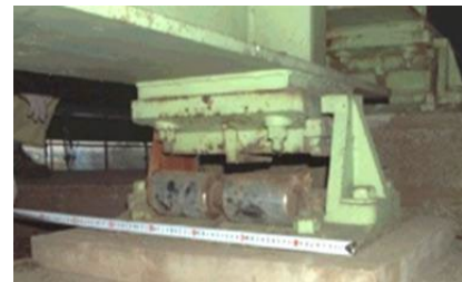
ローラーの脱落
