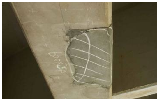
断面修復部のうき
