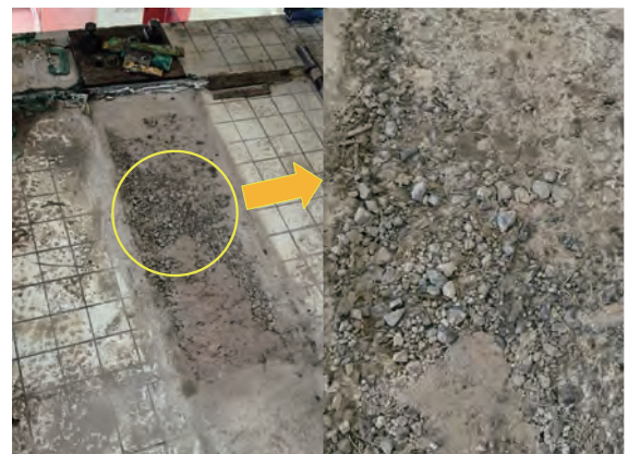
図-12 床版上面の砂利化状況（試験終了時）
