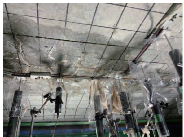
図-11 床版下面の漏水状況（走行回数1500万回）
