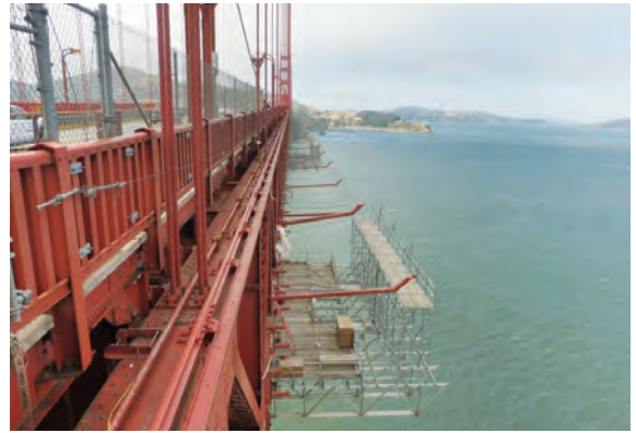
写真-17 落下防護柵
