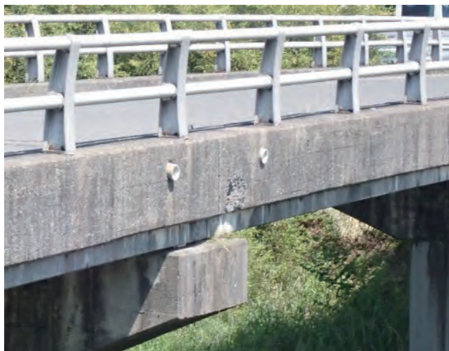
図-1 横締めPC鋼材が破断し側面に突出した橋（鋼材撤去後）
