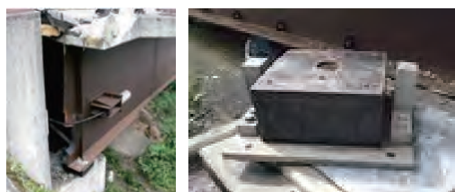
図-1 桁端部や支承の損傷
