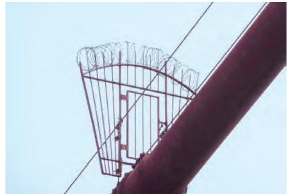
写真-18 自殺者浸入防止柵
