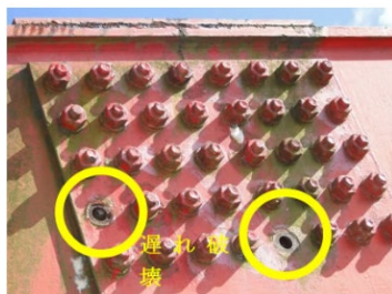
ボルトの脱落
