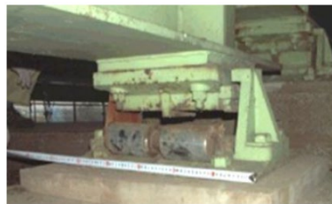
ローラーの脱落
