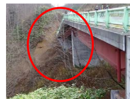
斜面上基礎の洗堀
