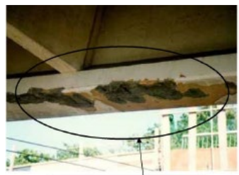
剥離・鉄筋露出が目視できる
