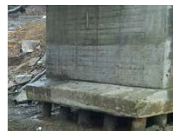
杭基礎の露出
