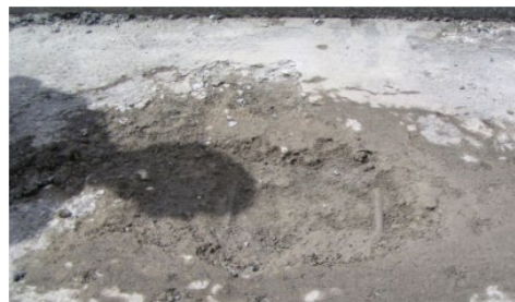
床版上面の土砂化(舗装を撤去)
