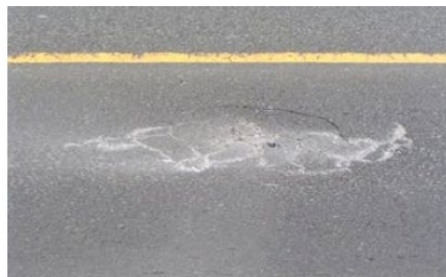
舗装ひびわれから白色析出物
