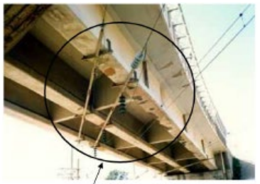
剥離・鉄筋露出が目視できる
