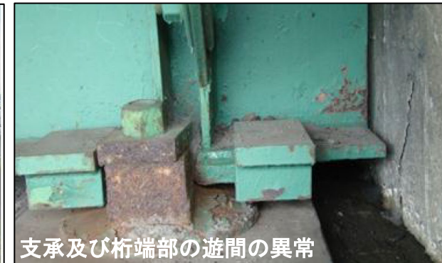
【支承の機能障害】
